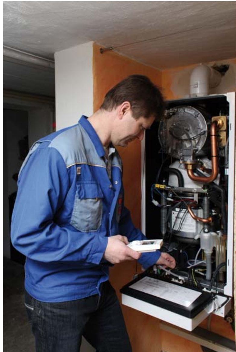
Kompaktes Wandgerät: Ingo Wiggers ist stolz auf die Heizungsinnovation in seinem Keller.
