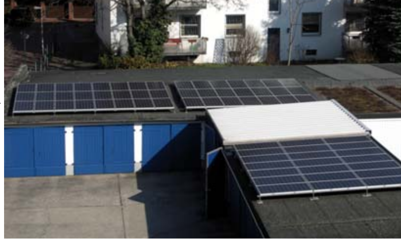
Solarenergiegewinnung in der hannoverschen Südstadt: Die Module wurden aus optischen Gründen flach auf die unbeschatteten Garagendächer im Innenhof montiert.
