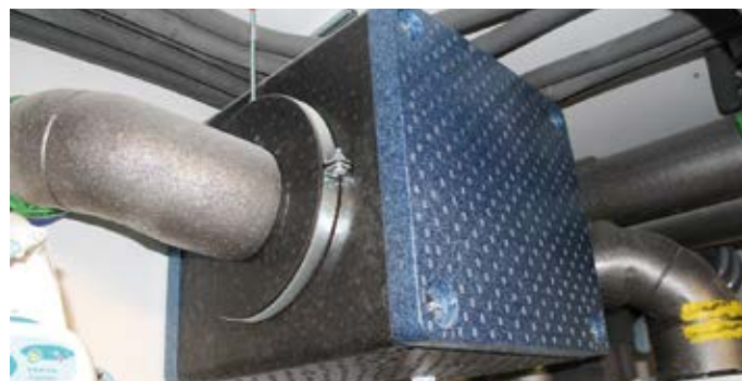
Bevor kalte Frischluft ins Haus gelangt, wird sie über diesen Wärmetauscher vorgewärmt.
